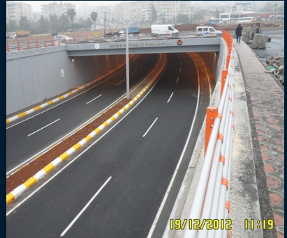
Aralık 2022'de Açıldığı İddia Edilen Alt Geçidin 2012'deki Tamamlanma Aşaması
